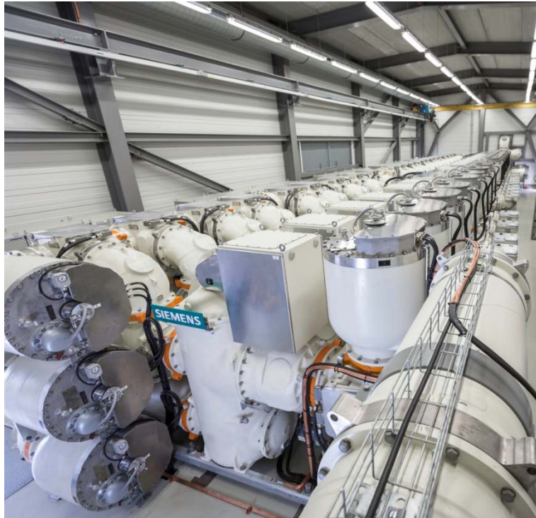
Abbildung 2: Gasisolierte Schaltanlage für bis 145 kV, Großkraftwerk Mannheim AG, 22 Felder 10
