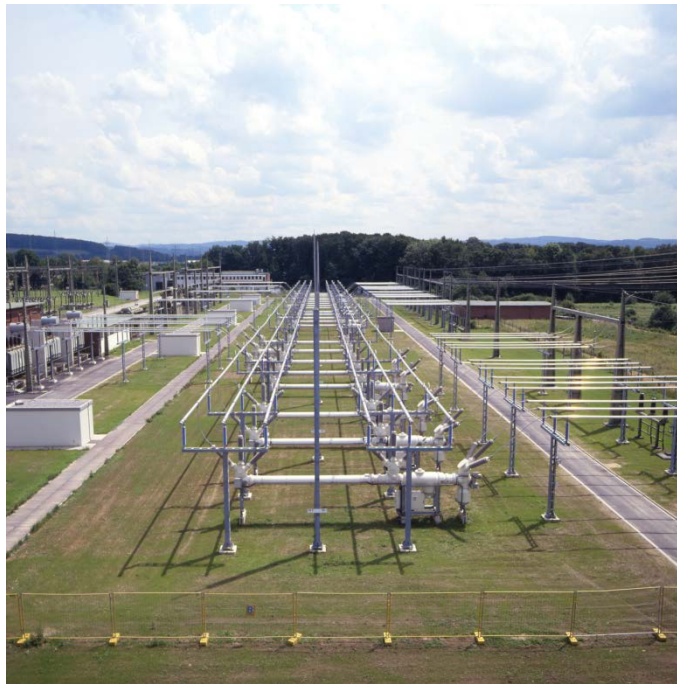
Abbildung 4: Luftisolierte Freileitung und Sammelschiene mit gasisolierten Schaltgeräten für 110 kV 12
